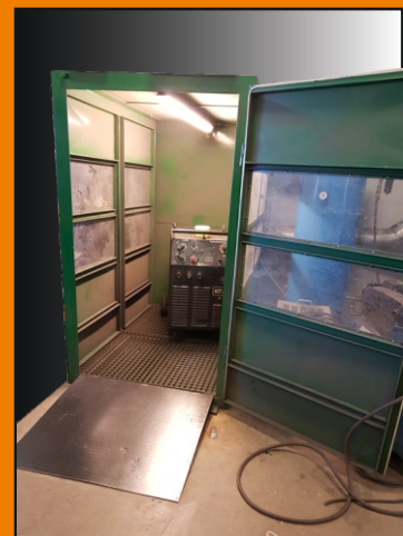
Odsávaný box pro vyfoukávání prachu z vnitřního prostoru svářeček pomocí stlačeného vzduchu.
